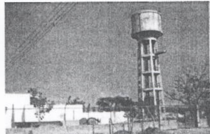
Los tanques elevados se deterioran por falta de agua.
